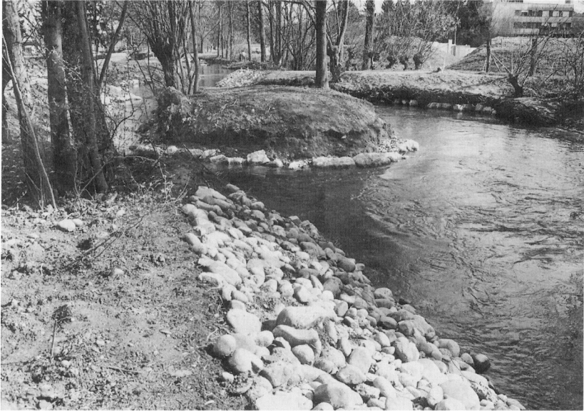
Das künstlich angelegte Mäanderbett der voraussichtlich von künftigen Überschwemmungen befreiten Langeten unterhalb der Mühle. Foto 1993 Martin Moser, Langenthaler Tagblatt.
